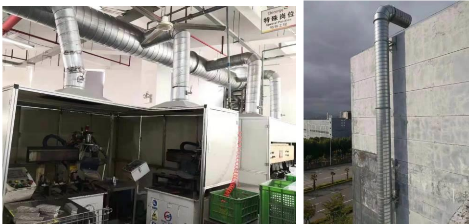
图 10.1-7 焊接废气收集措施及排气筒
