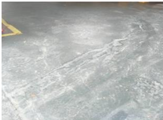
危险废物仓库地面防渗漏措施
